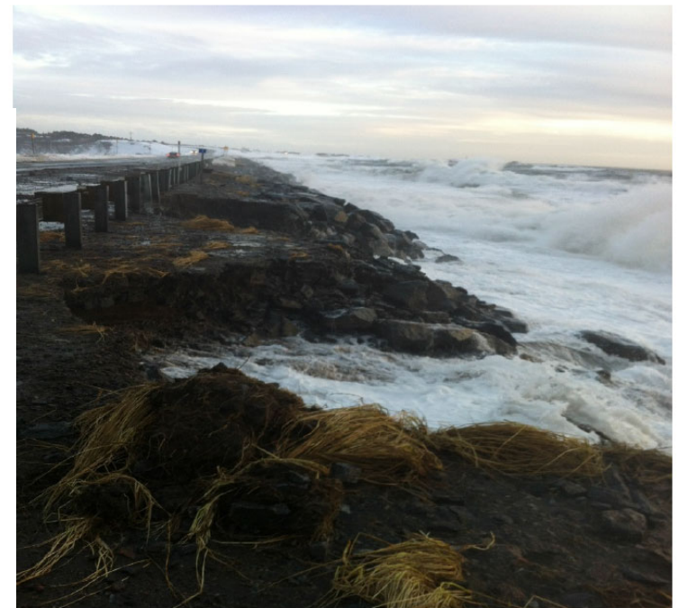
Figure 2-7. Dommages causés par les tempêtes du 30 décembre 2016
