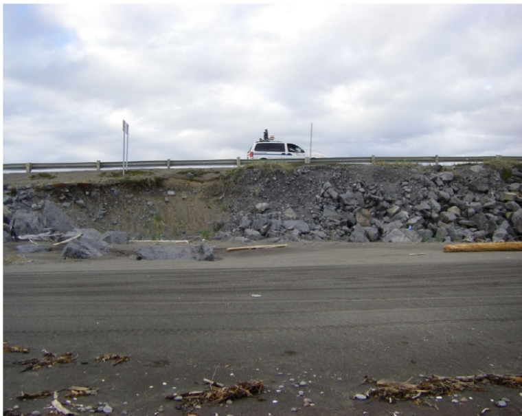
Figure 2-4. État de l'enrochement avant les travaux en juin 2011 (ch. 0+800)
