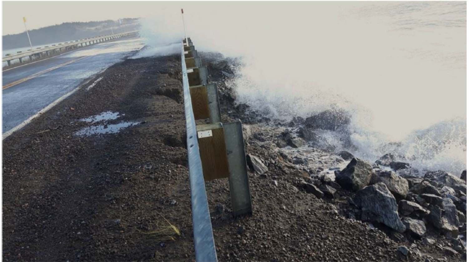
Figure 2-34. Débordement côtier induit par le franchissement des vagues (submersion côtière) – tempête du 13 novembre 2016
