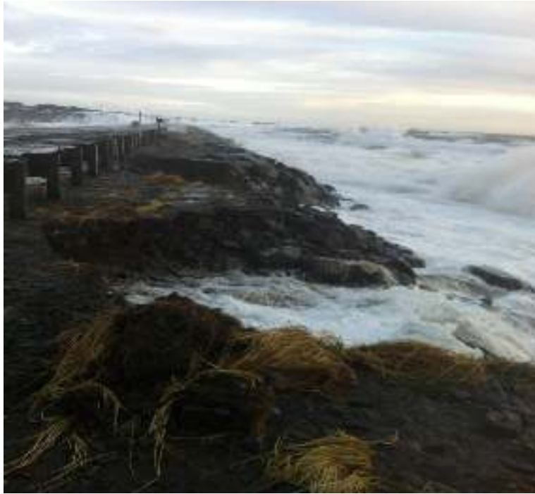
Figure 2-7. Dommages causés par les tempêtes du 30 décembre 2016
