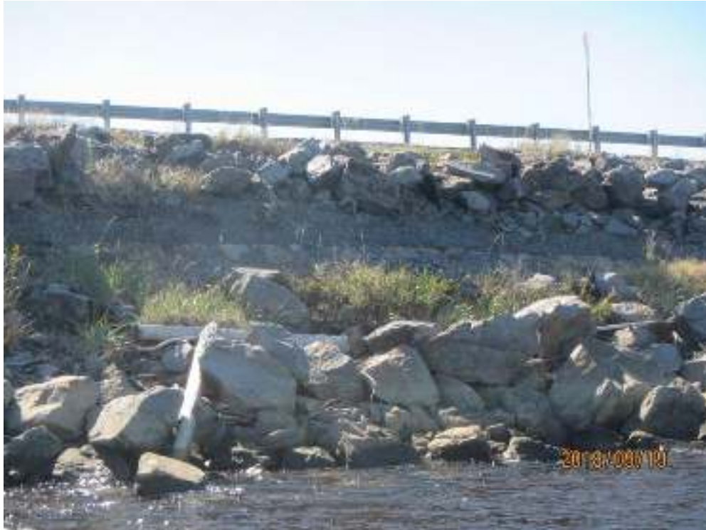
Figure 2-24. Décrochement en milieu de pente (ch. 0+420 à 0+540)
