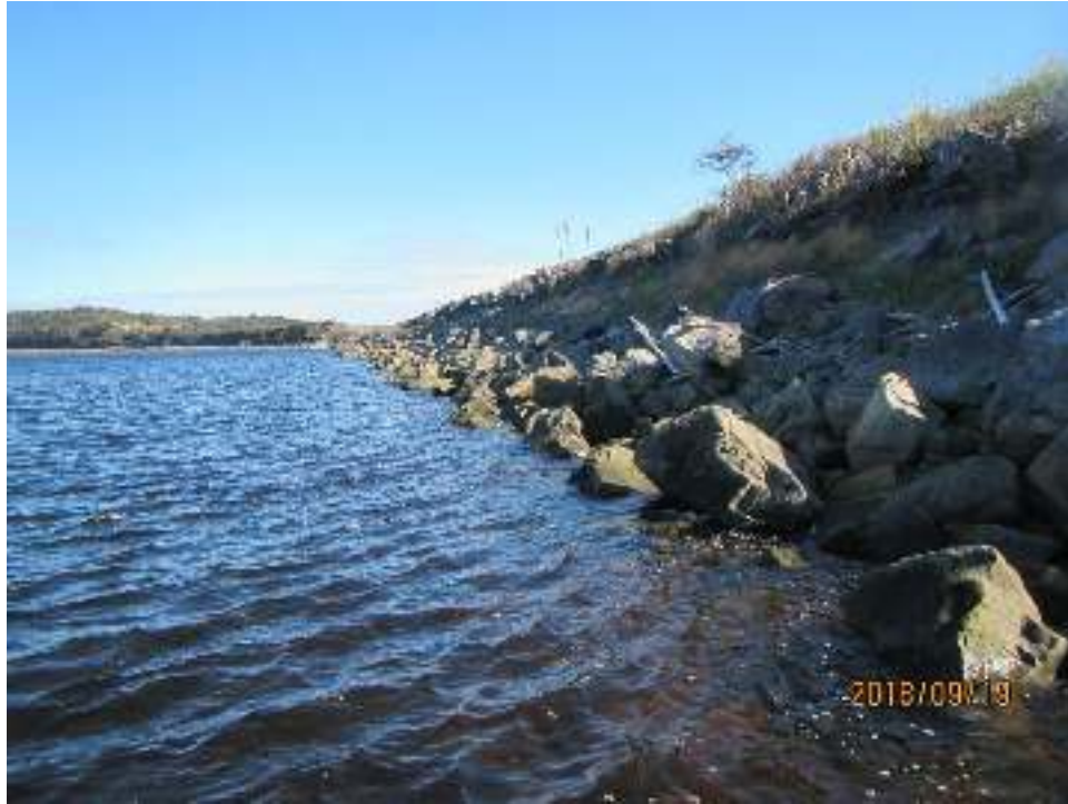
Figure 2-23. Empierrement qui présente certains signes de dégradation et dont le pied de l'ouvrage semble relativement stable (ch. 0+320 à 0+420)
