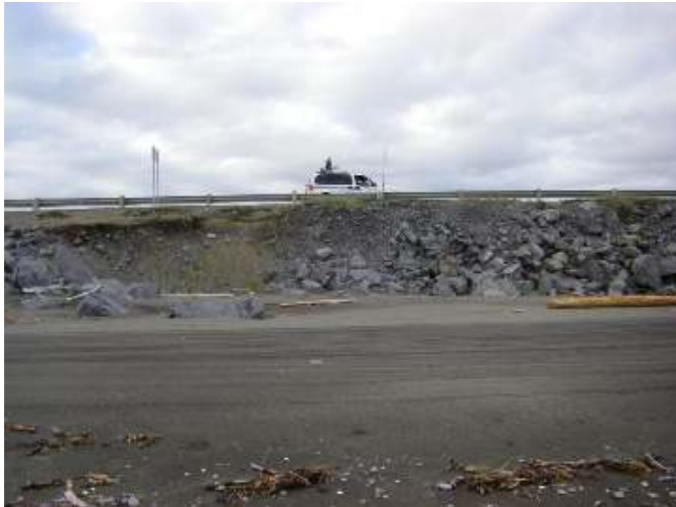
Figure 2-4. État de l'enrochement avant les travaux en juin 2011 (ch. 0+800)
