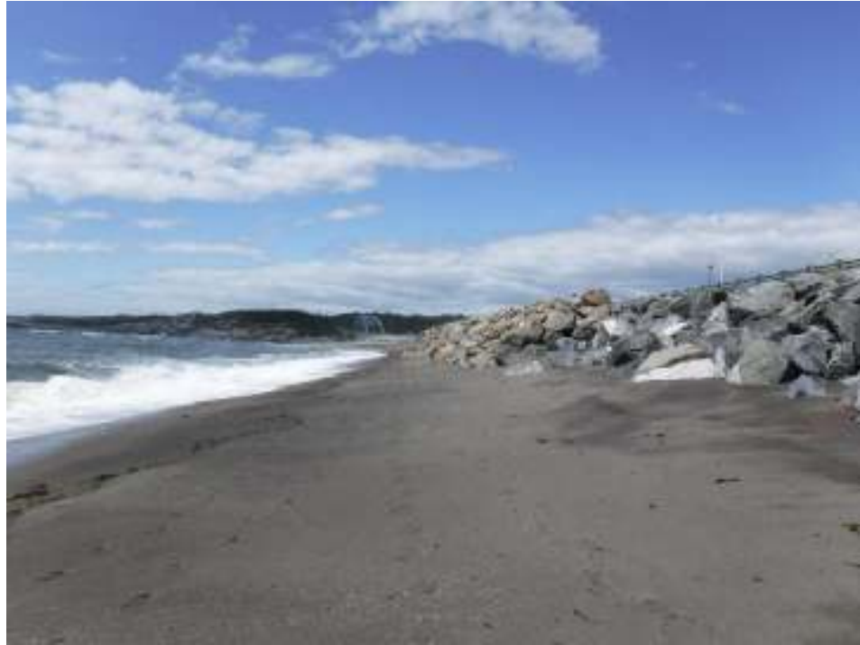
Figure 2-15. Transition entre deux sections d'enrochement avec une différence au niveau de l'élévation de la crête et de la pente (ch. 0+440) – septembre 2018
