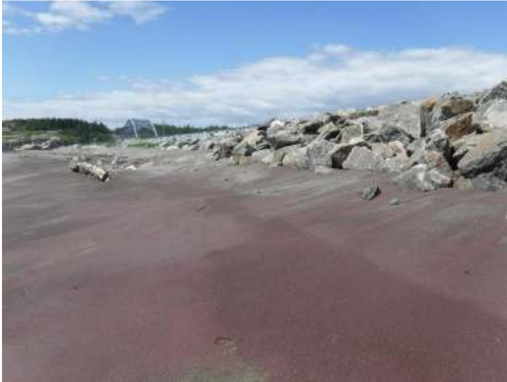
Figure 2-18. Pente de la plage devant l'enrochement – présence (ch. 0+150) et absence (ch. 0+300) de berme de plage (plage sèche)
