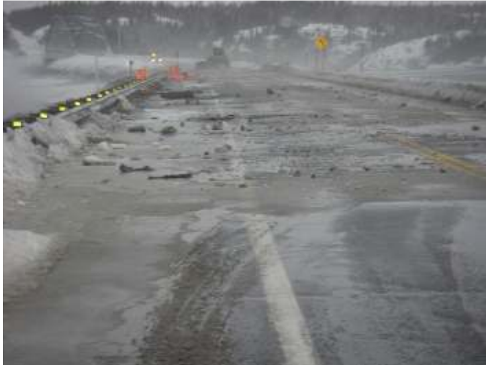
Figure 2-33. Débordement côtier induit par le franchissement des vagues (submersion côtière) – tempête du 11 janvier 2017
