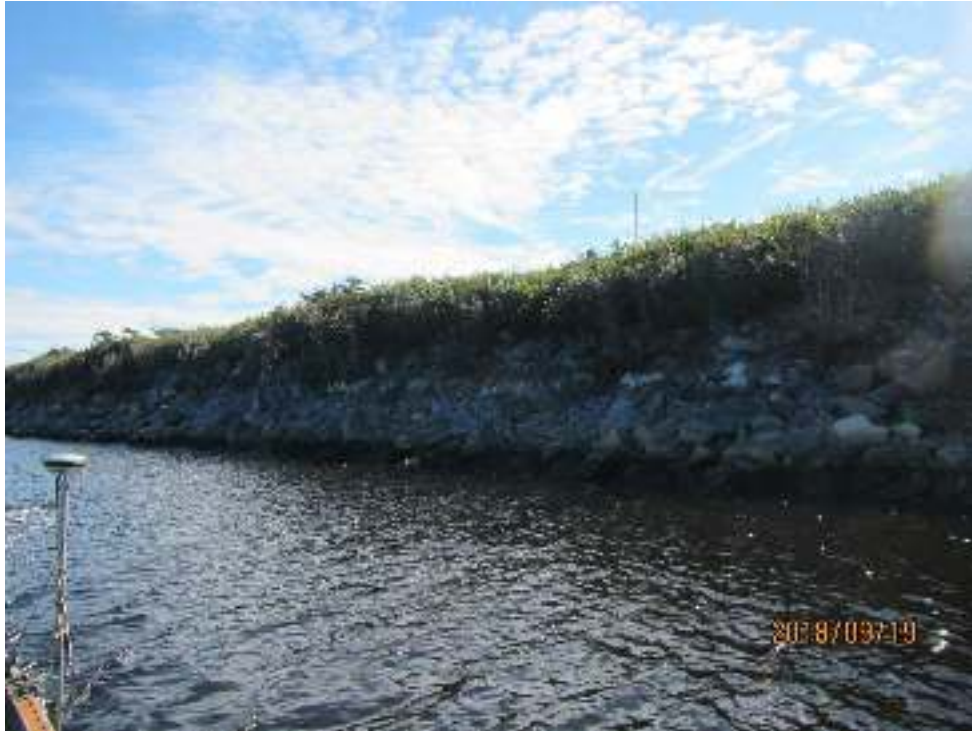
Figure 2-22. Dégradation significative de l'enrochement dans le bas du talus routier et signes d'érosion notables – côté nord (ch. 0+200 à 0+320)
