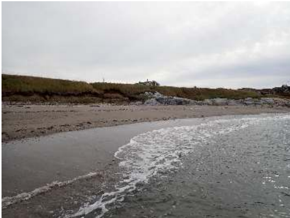
Figure 2-32. Encoches d'érosion dans le bas du talus tout juste à l'ouest du cran rocheux (ch. 1+800)
