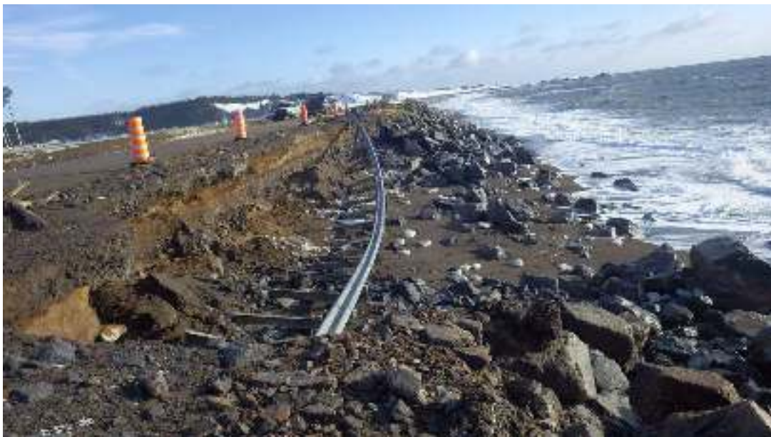
Figure 2-19. Plage submergée à marée haute – dommages subis à la suite de la tempête du 30 décembre 2016 (ch. 0+300)
