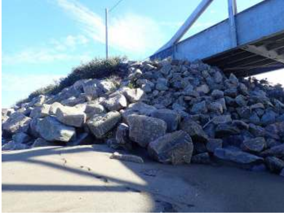
Figure 2-12. Culée est du pont Touzel et empierrement de protection – (ch. 0+090)
