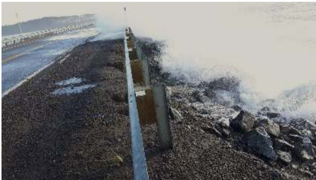
Figure 2-34. Débordement côtier induit par le franchissement des vagues (submersion côtière) – tempête du 13 novembre 2016
