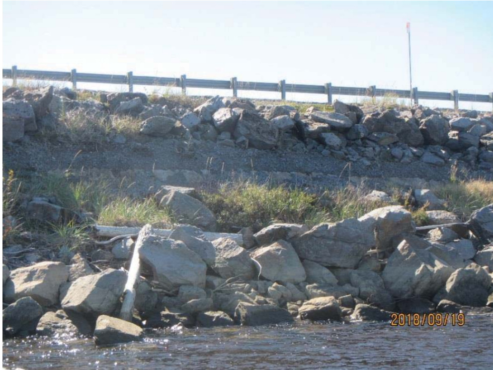
Figure 2-24. Décrochement en milieu de pente (ch. 0+420 à 0+540)
