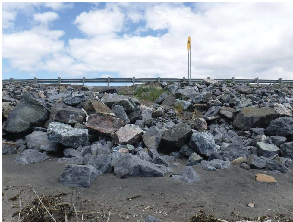
Figure 2-16. Déversement de pierres de calibre étalé et encoche d'érosion en crête (ch. 0+800) – septembre 2018
