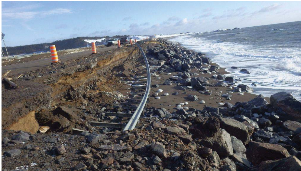
Figure 2-8. Dommages causés par les tempêtes du 30 décembre 2016 (ch. approx. 0+440 à 0+500)
