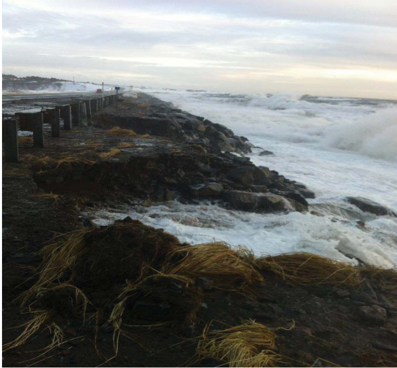
Figure 2-7. Dommages causés par les tempêtes du 30 décembre 2016
