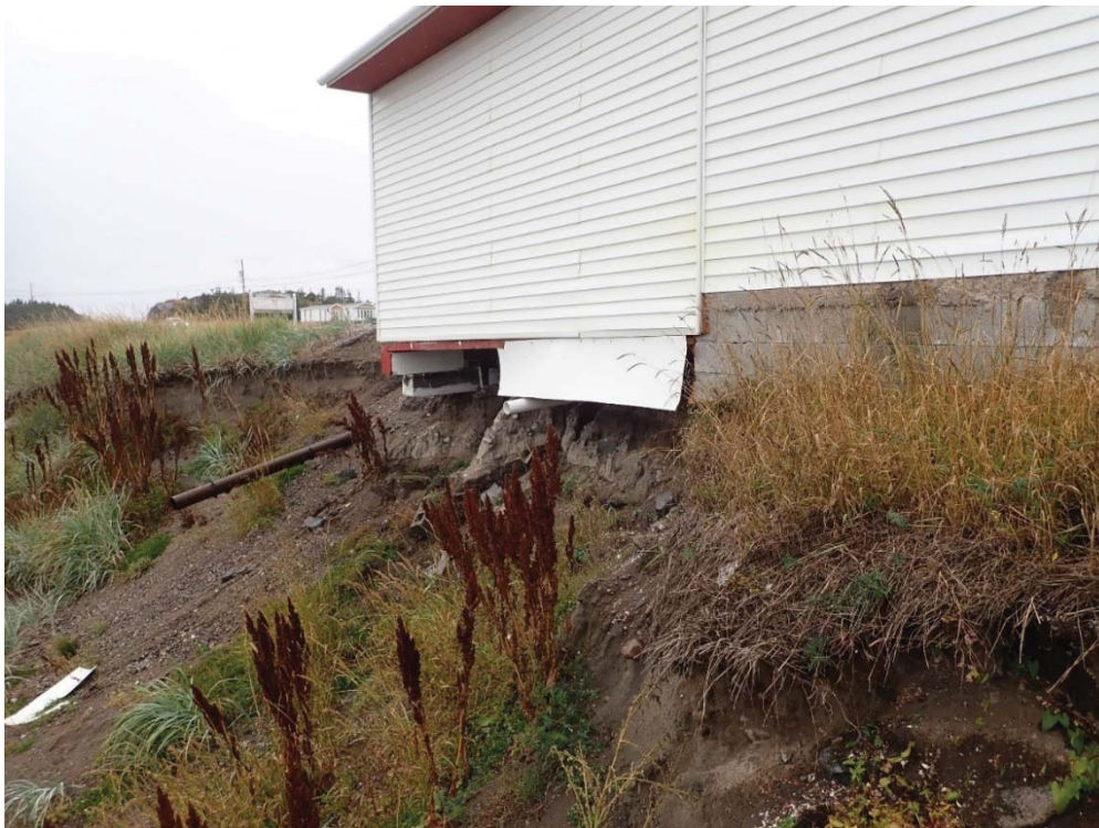
Photo 14 : État de la berge au chaînage 2+200, vue vers l'ouest
