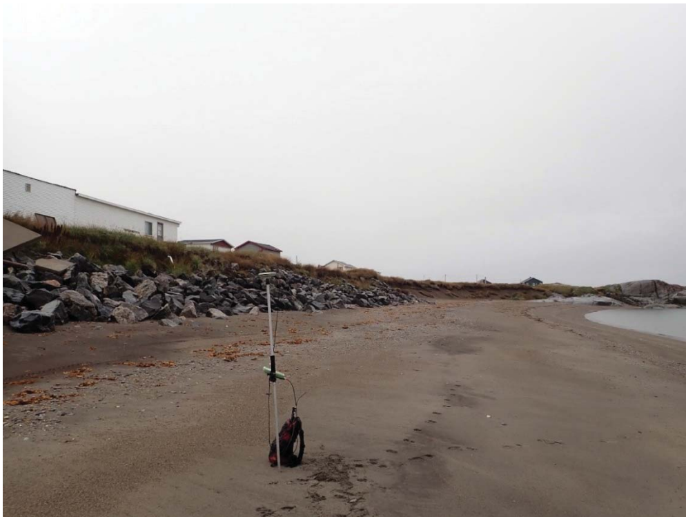
Photo 12 : État de l'enrochement actuel au chaînage 2+100, vue vers l'est
