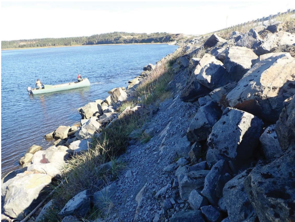
Photo 6 : État de l'enrochement le long de la route 138 du côté de la rivière Sheldrake
