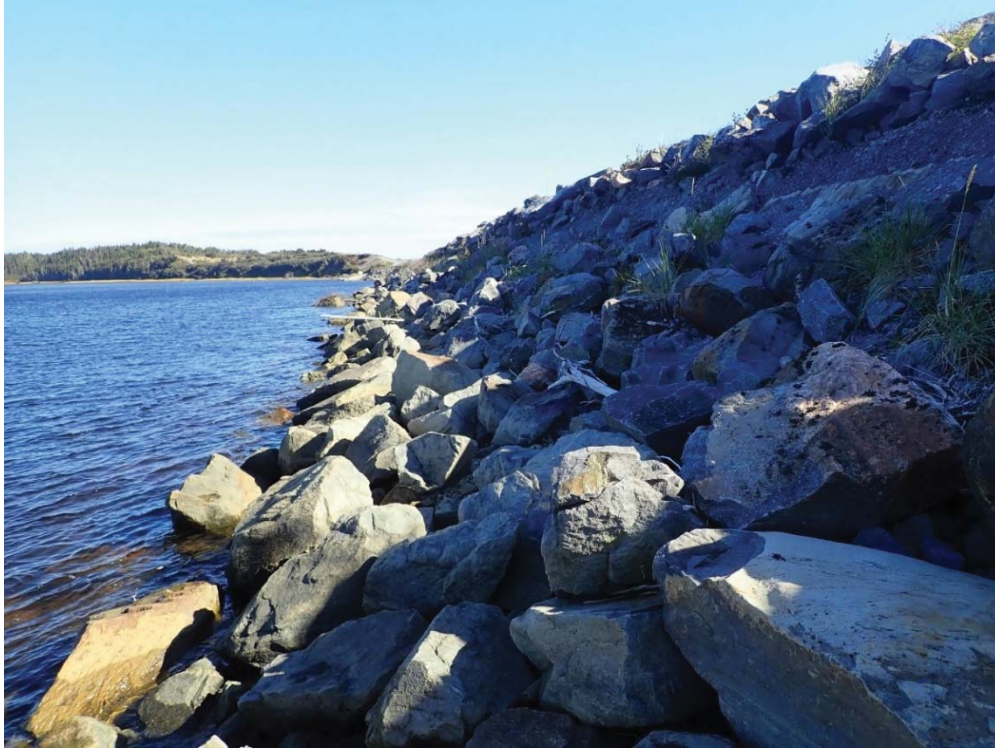
Photo 5 : État de l'enrochement le long de la route 138 du côté de la rivière Sheldrake
